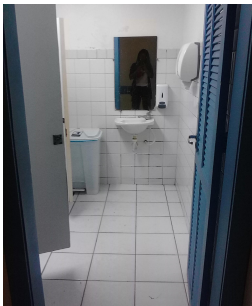
Fotografia 25 e 26: Banheiros não adaptados para receber PCDs
